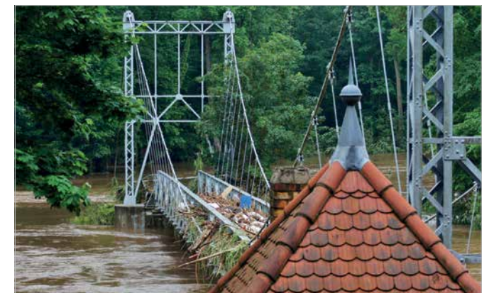
Die Wassermassen beschädigten auch Sachsens längste Hängeseilbrücke mit einer Spannweite von über 80 m stark. Sie verbindet das Stadtgebiet von Grimma mit dem Stadtwald. Foto: Oliver Diecke
